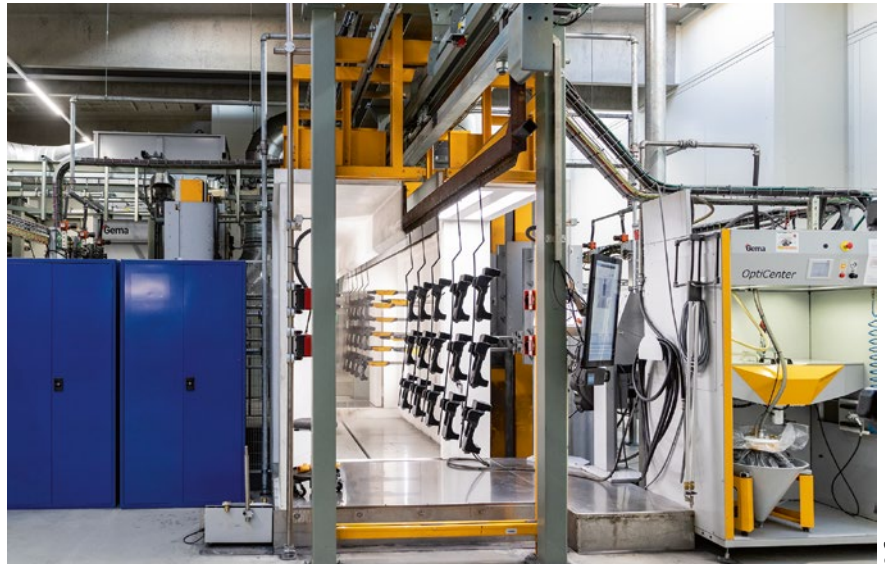
Die Pulverbeschichtung bei Birn A/S ist kompakt gebaut und flexibel nutzbar.
