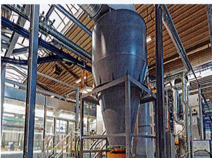
Die Anlagentechnik musste größtenteils in bestehende Hallen eingepasst werden.
